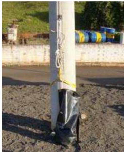
Figura 32 – Instalação do trava-quadras na parte da linha de vida do nó oito duplo
